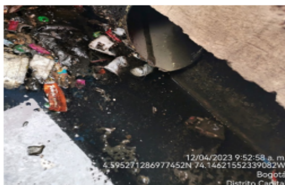
Fotografía No. 21 Descarga del agua a la trampa de grasas.
