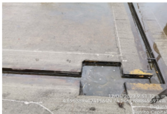
Fotografía No. 19 Se observa que el sifón colmatado del canal perimetral ubicado en el área de almacenamiento de combustible, costado suroccidental.
