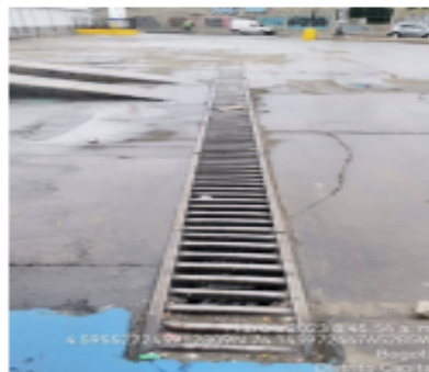
Fotografía No. 30 Rejilla perimetral zona de lavado de vehículos.
