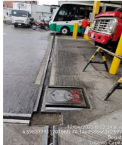
Fotografía No. 2 Canales perimetrales área de distribución de combustible.
