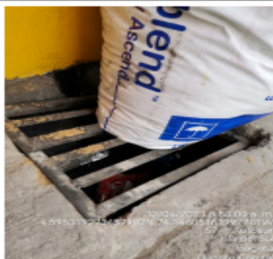
Fotografía No. 25 Cajas contenedoras de agua lluvia, en la cuales descarga la red de agua lluvia del canopy, ubicadas en los costados de los dispensadores de combustible
