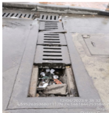
Fotografía No. 22 Se evidenció residuos sólidos en las rejillas perimetrales, sectores entrada y salida de la EDS.
