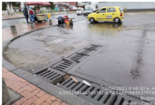
Fotografía No. 8 Rejilla perimetral ubicada en el costado suroriental, sector salida de la EDS.
