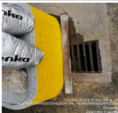
Fotografía No. 26 Cajas contenedoras de agua lluvia, en la cuales descarga la red de agua lluvia del canopy, ubicadas en los costados de los dispensadores de combustible
