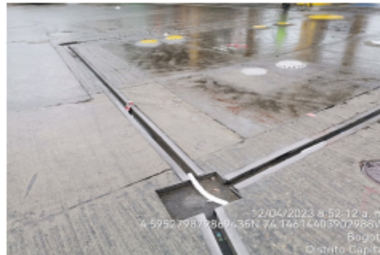
Fotografía No. 4 Canales perimetrales área de almacenamiento de combustible.
