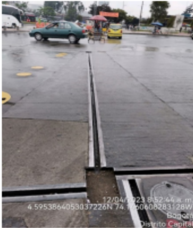
Fotografía No. 3 Canales perimetrales área de almacenamiento de combustible.
