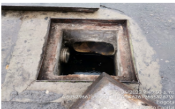
Fotografía No. 23 Caja de inspección interna, ubicada en el costado sur de la EDS.
