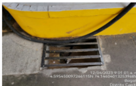
Fotografía No. 24 Cajas contenedoras de agua lluvia, en la cuales descarga la red de agua lluvia del canopy, ubicadas en los costados de los dispensadores de combustible
