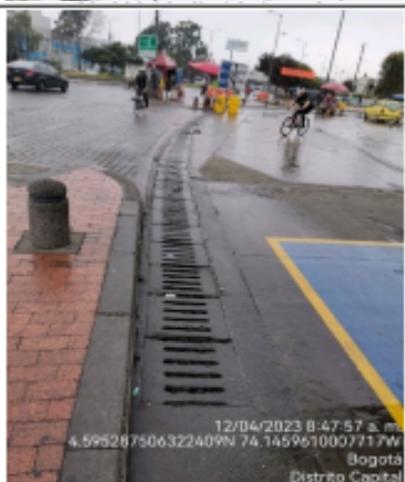
Fotografía No. 7 Rejilla perimetral ubicada en el costado suroriental, sector salida de la EDS.
